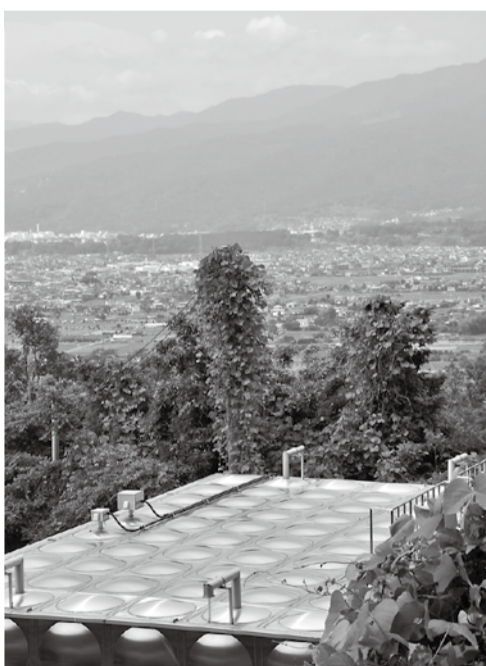
▲麻子の配水池
