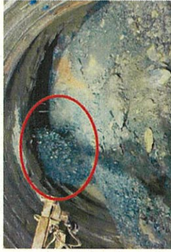
トンネルの天端や切羽が崩落し、土砂が落下
