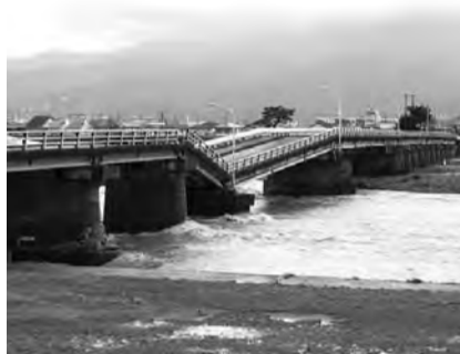
落橋した十文字橋(平成19年)
