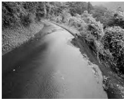
土砂崩れが発生した町道寄11号線(平成22年)
