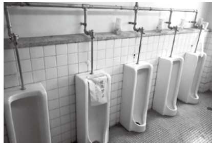
老朽化したトイレ
