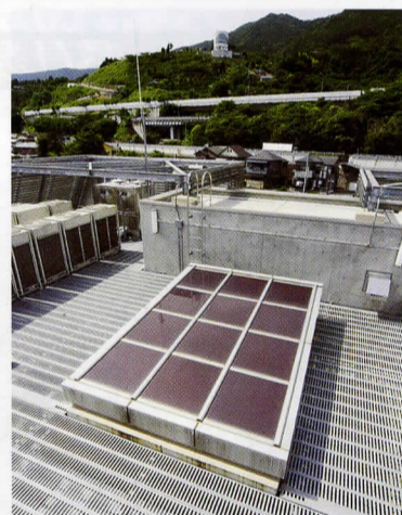
◀ 役場屋上に設置されているソーラーパネル
