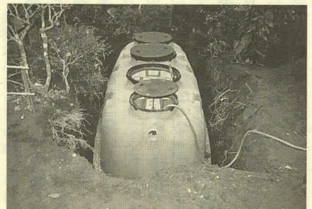
設置される合併処理浄化槽
