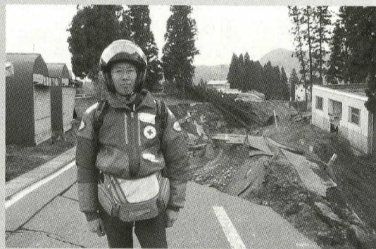
▶震源地に近い小千谷市塩殿地区の災害現場で一枚、崩落した道路に、地震の脅威を思い知らされました。
