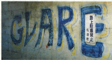
コンクリート壁への落書き
