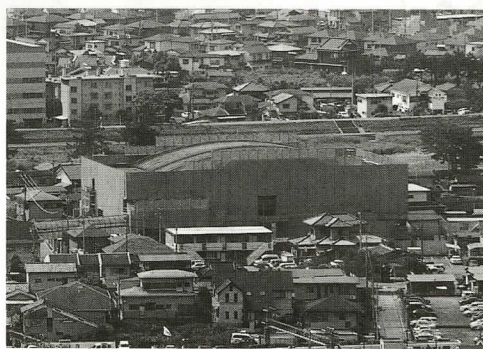
▲改造工事中の松田中学校屋内運動場(5月21日、松田山より撮影)
