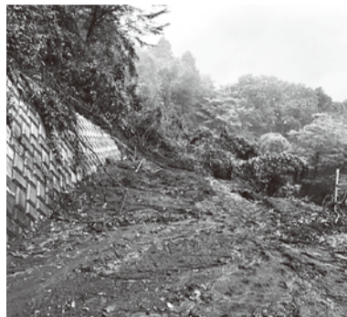
土砂崩落の様子
