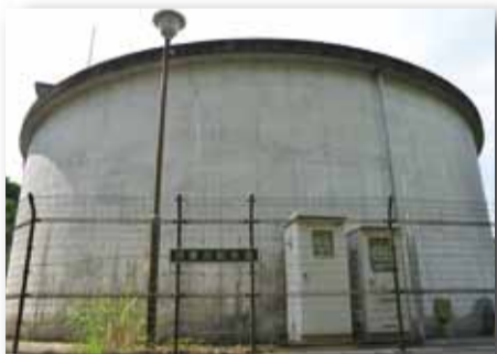
主に松田惣領地区を配水エリアとする河南沢配水池
