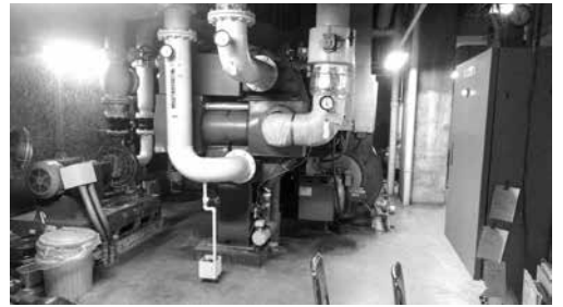
ESCO事業 冷温水発生装置
