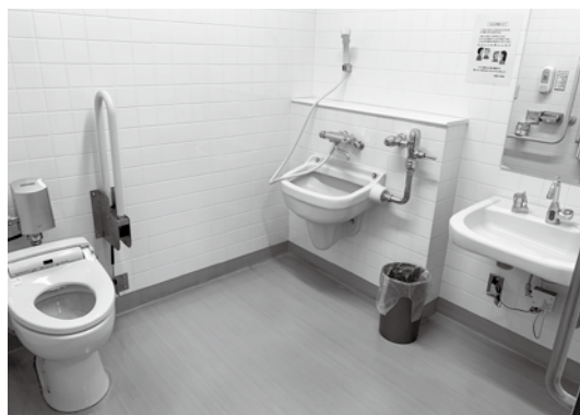
庁舎多目的トイレ
