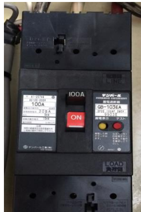
④ブレーカー
