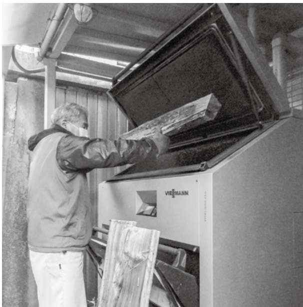
稼働する新ボイラー
