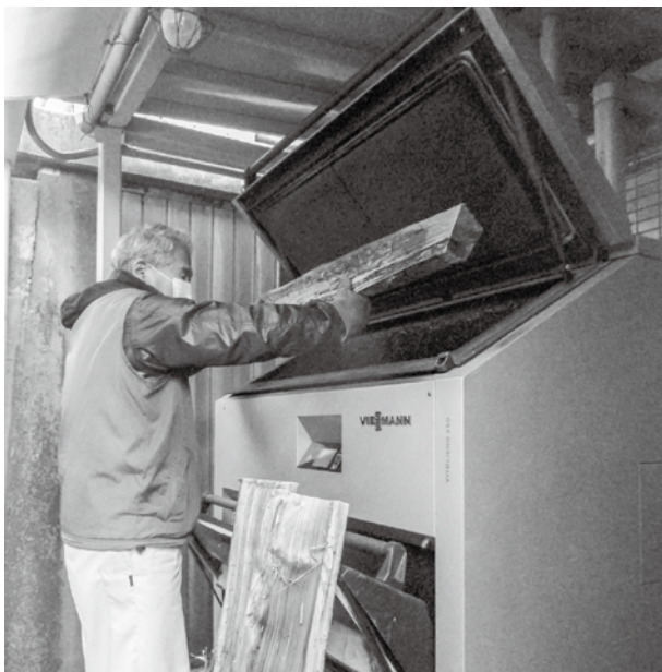
稼働する新ボイラー
