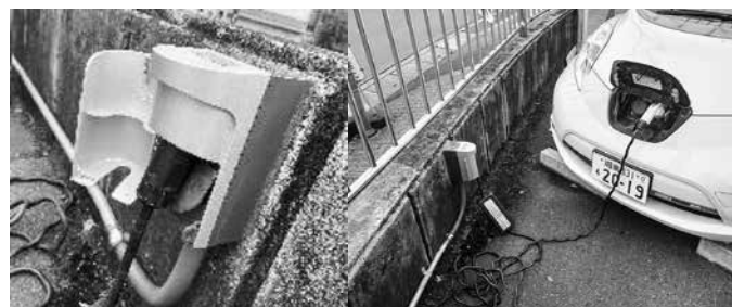
電気自動車充電設備(例)
