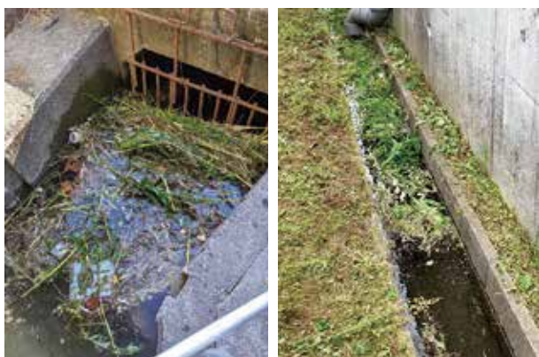
水路にゴミが詰まっている状況
