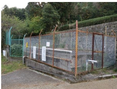
大寺北第1,2配水池
