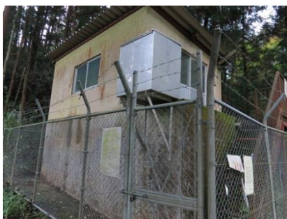
宮地・田代第2水源施設
