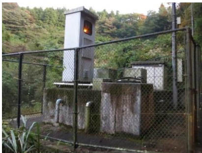
萱沼送水ポンプ場
