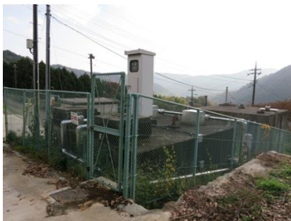
宇津茂第2,3配水池
