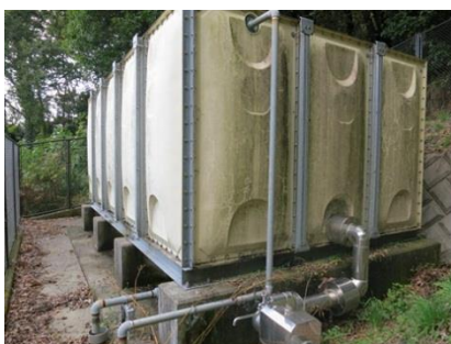
上茶屋配水池
