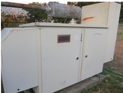
自家発電設備
