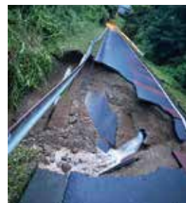
▲町道寄4号線陥没
