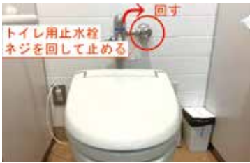
トイレの止水栓
