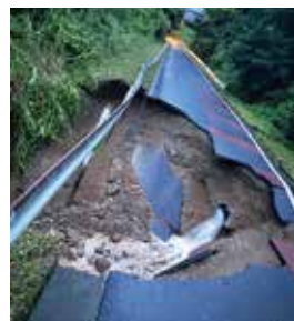
▲町道寄4号線陥没
