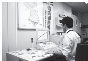
同報無線の基地局操作盤
