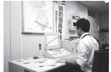
同報無線の基地局操作盤
