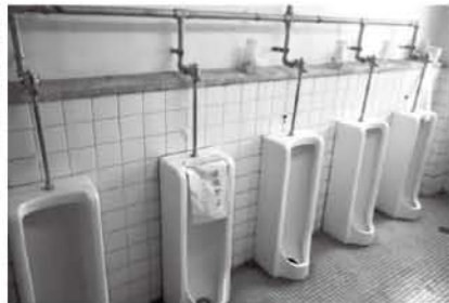
老朽化したトイレ
