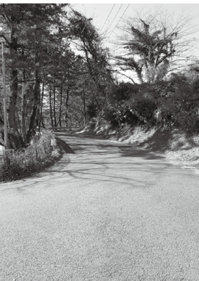
拡幅が望まれる秦野市道20号線
