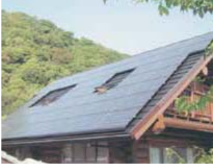
◀補助金を利用して設置した村野実さん宅の太陽光発電システム、村野さんは「エコにも節約にも役立つ」と語ります。
