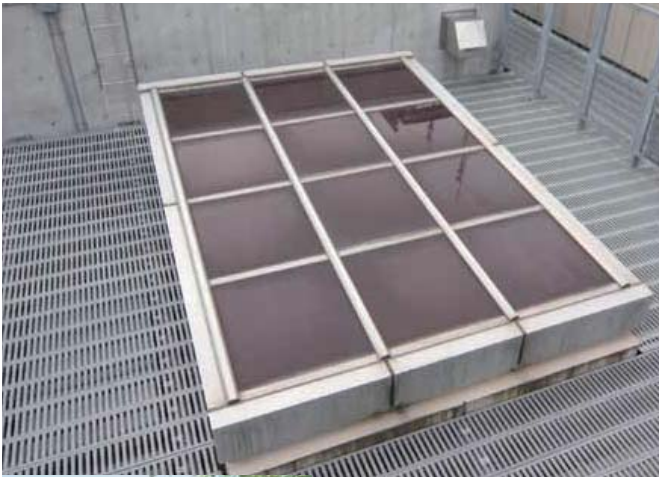
▲町役場屋上の太陽光発電システム
