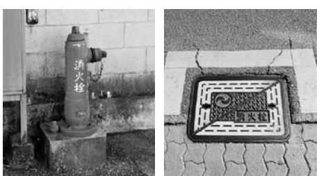
左：地上式消火栓、右：地下式消火栓
