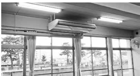
松田中学校に設置されたエアコン
