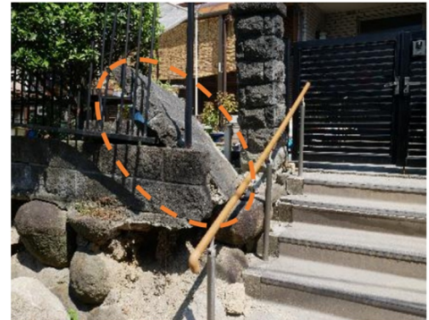
図表 4-16 ブロック塀倒壊
